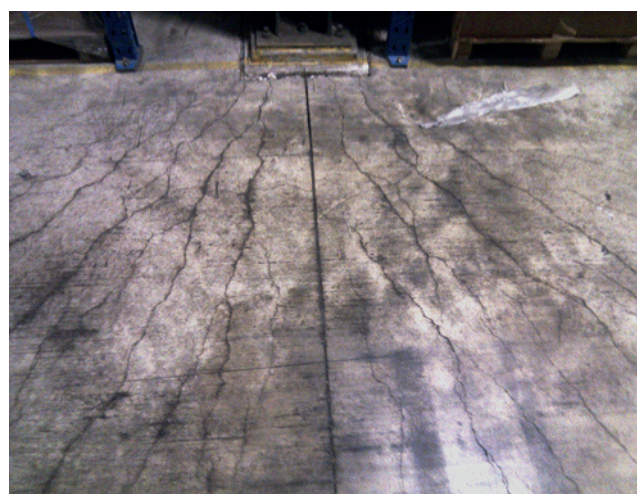
Vloer met grote zetting die blijft hangen aan een kolom
